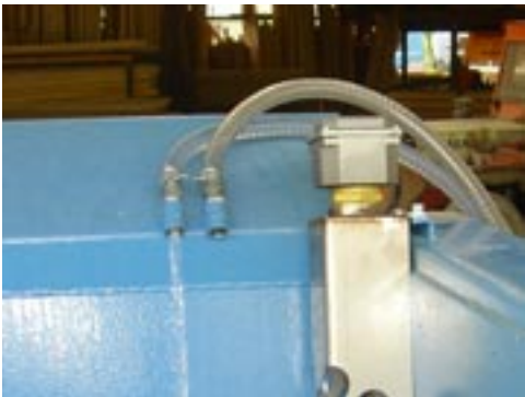
Le mélange alimente directement le bac
