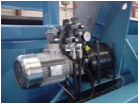
Groupe hydraulique avec by-pass, leds de contrôle sur bobines et limiteurs de pression
