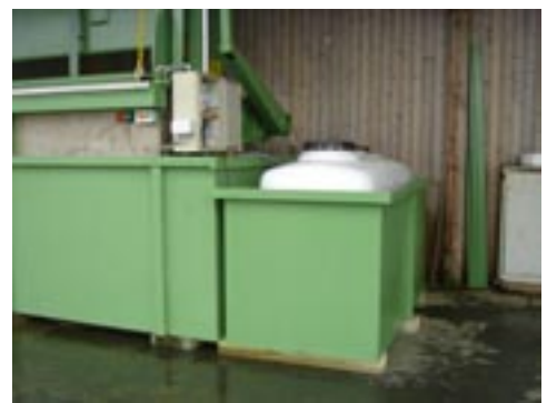
Rétention séparée grande capacité.
