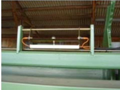
Sécurité de niveau précise sur bacs 774 à double châssis et 826
