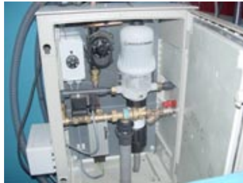
Armoire isolée et chauffage thermostatique
