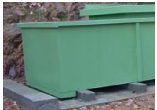
Rétention plus longue et puisard de pompage
