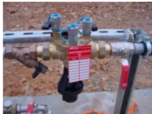
Le client doit prévoir un disconnecteur
