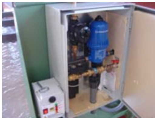
Tout est intégré dans une armoire protégée du gel
